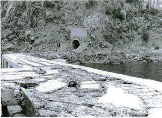
写真-9 改修前のトロッコ跡 15)
